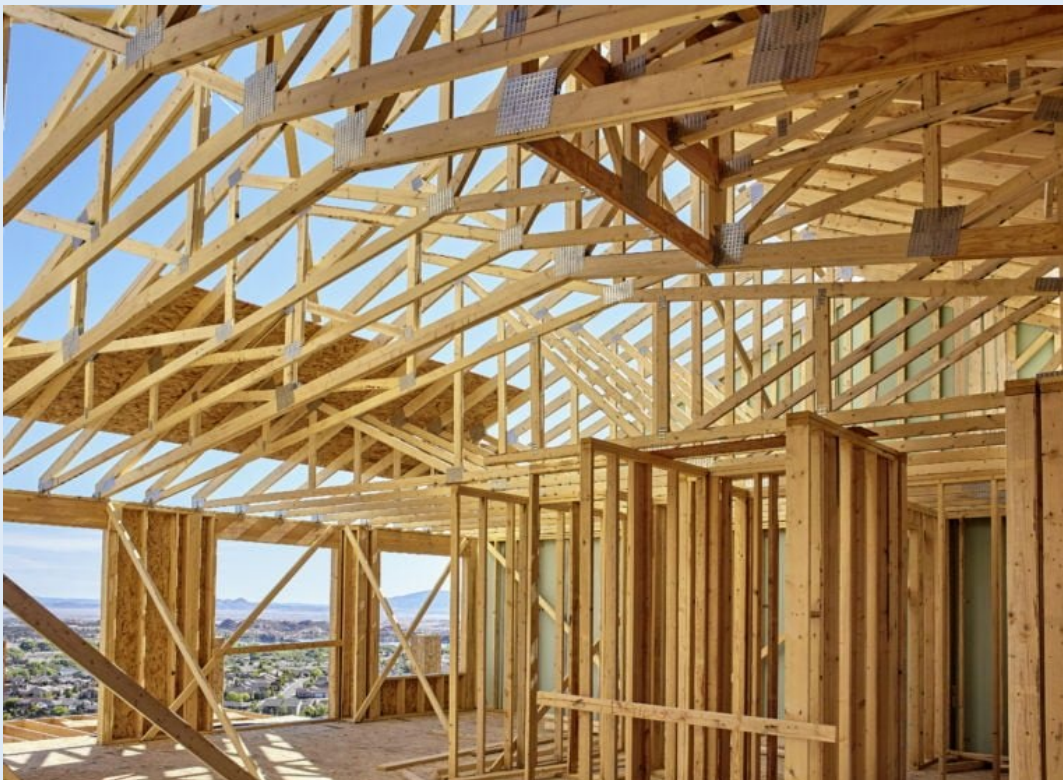
Wiązary nożycowe w części mieszkalnej o zróżnicowanym kącie pochylenia pasów górnych i dolnych
