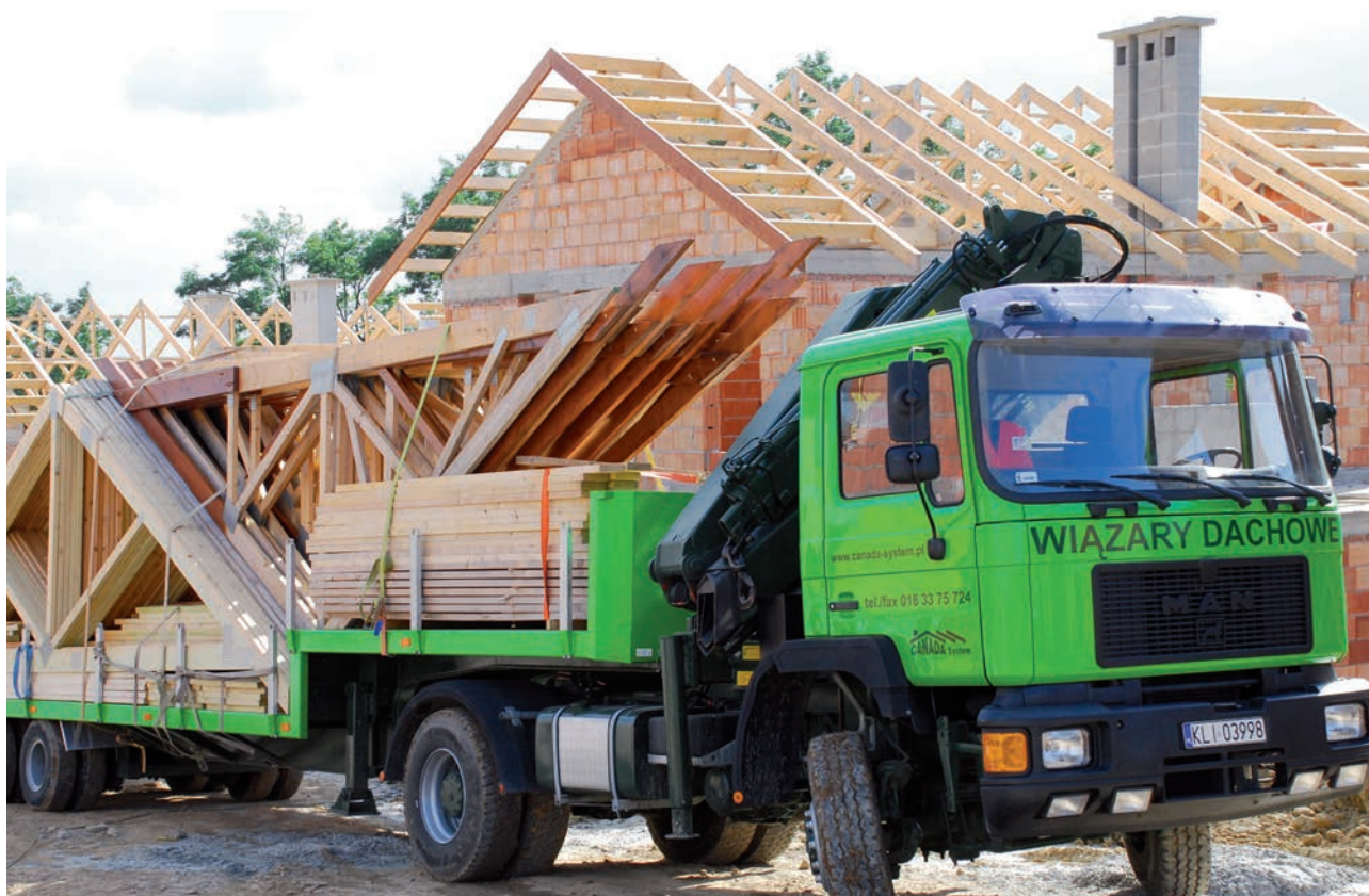
Dostawa wiązarów na plac budowy (realizacja CANADA-SYSTEM). Czas montażu więźby to około 5 godzin.
